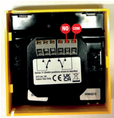
Fig 11: Interior del relé del Botón Manual
